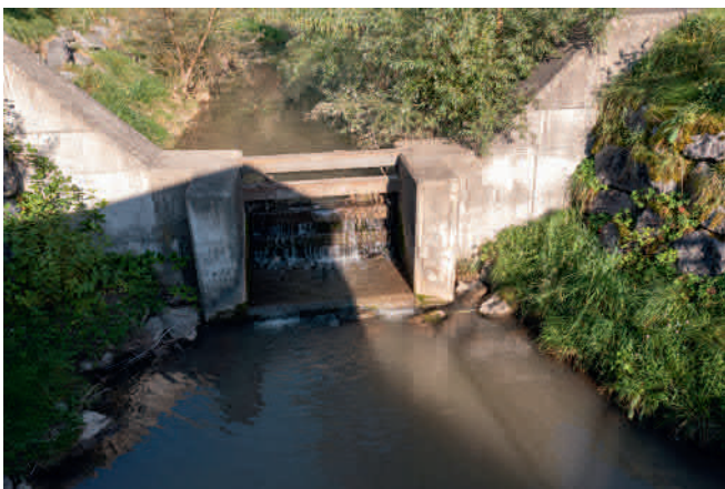
Abbildung 7: Geschiebeablagerungsplatz Rappenbach/Mühlebach in Schönis: Dambalkensperre. | Figure 7 : Emplacement de dépôt des sédiments Rappenbach/Mühlebach in Schönis : barrage en poutres.
